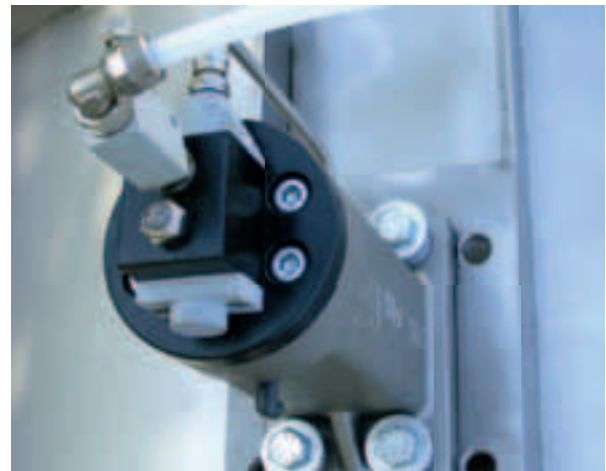
Druckluft-Intervallklopfer an der Filter-Außenwand
