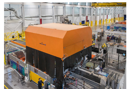
KMA-Abluftfiltersystem an der Druckgießmaschine.
