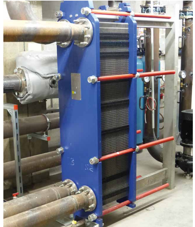
Bild 4: Zweite Wärmetauscherstufe, Detailaufnahme Plattenwärmetauscher.
