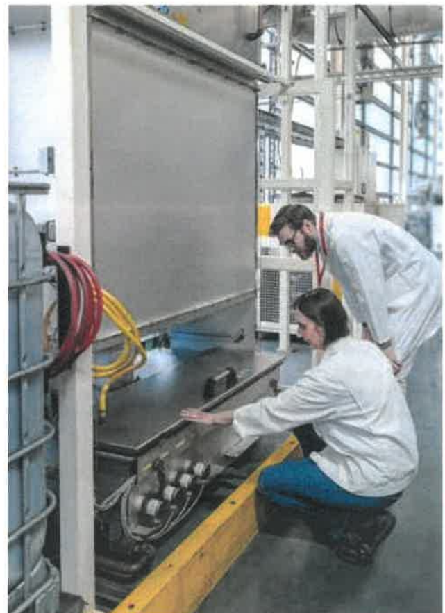
Michaela Hauptlorenz (Valeo) and Milan Wlömer (KMA Umwelttechnik) in front of the exhaust air purification system.
